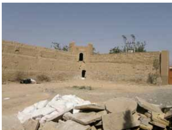
تصویر ۱۲: فضای درونی اصطبل که به طور کامل تخریب شده است؛ مأخذ: اداره میراث فرهنگی کاشان.
